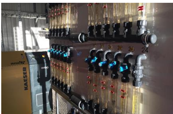
Styring av innblåsing av luft
