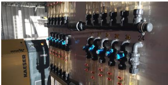
Styring av innblåsing av luft.
