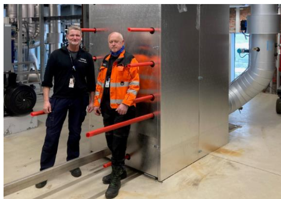
Varmeveksling mot avløpsvann i DA8
